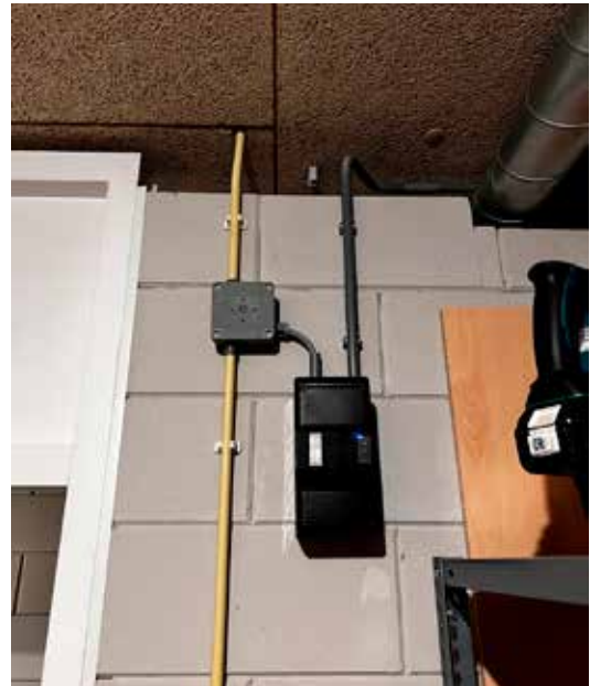
In de voeding vanuit de meterkast naar de bergingen is een stuur/relaiskastje geplaatst.
